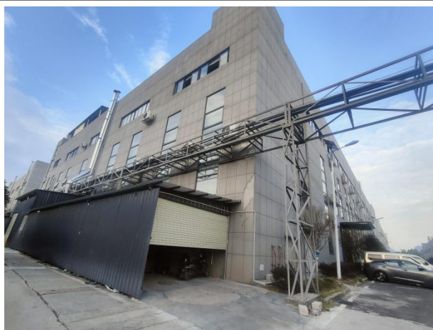
布袋除尘器排气筒
