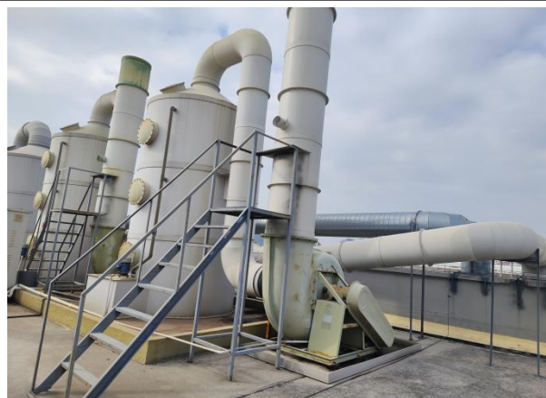
酸碱喷淋塔及排气筒
