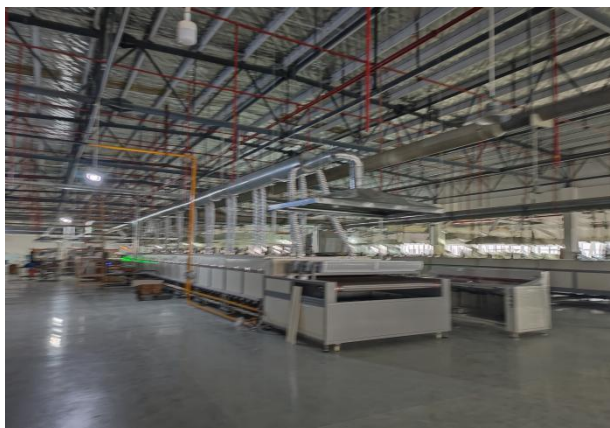
废气集气系统
